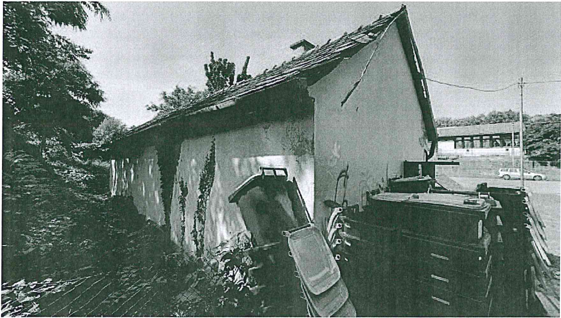
Bal oldali épületrész oldalsó homlokzata az erősen omladozó tetővel
