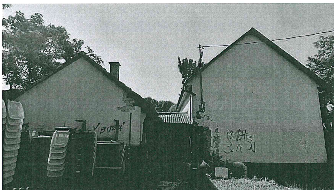
A főbejárat, jobb oldali épületrész bal sarkánál ereszcsonna hiánya miatti ázás
