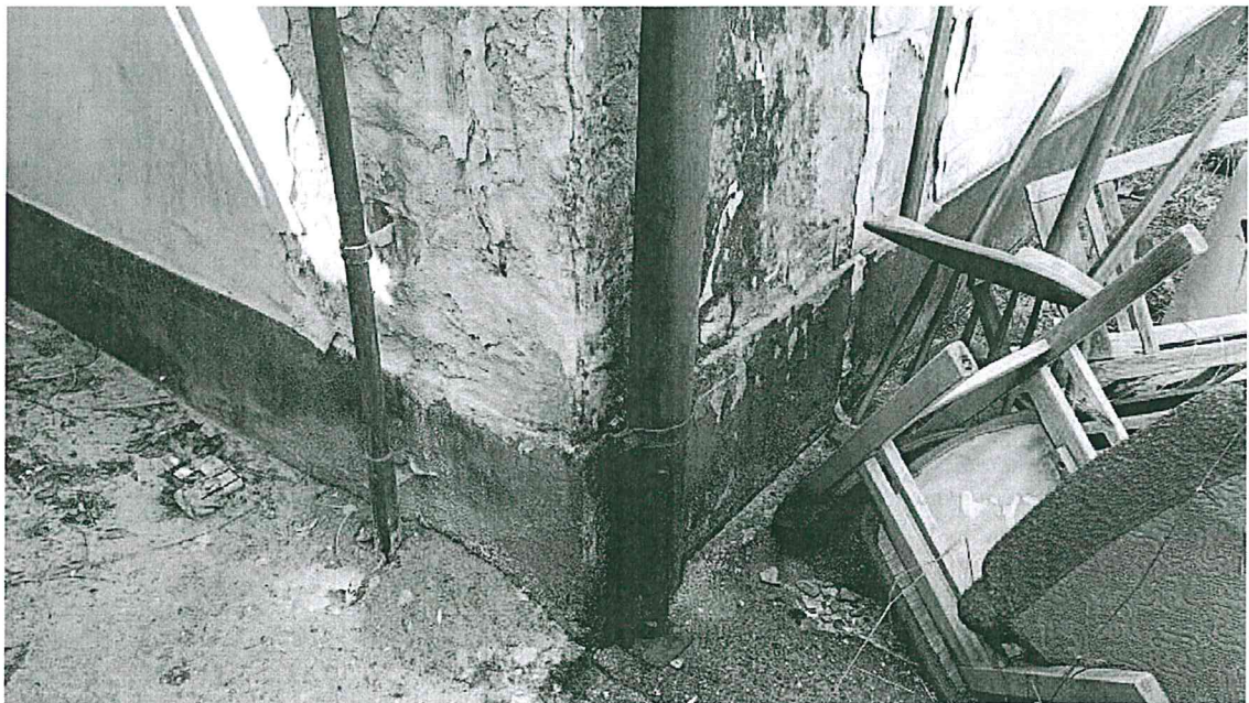
A tornatermi épületrész bal sarkánál ereszcatorna hiánya miatti ázás
