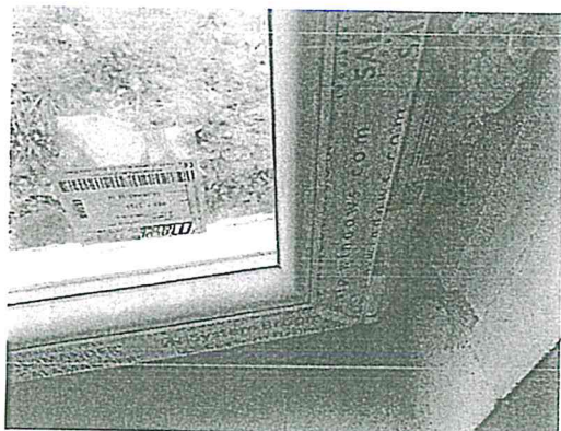
22. fénykép: Beépített műanyag nyílászáró
