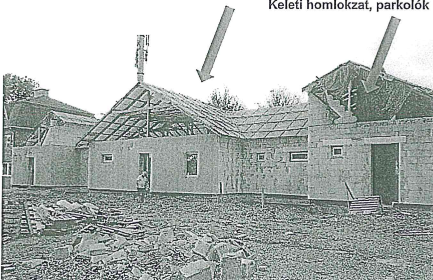
9. fénykép: Keleti homlokzat, időjárás elleni védelem hiánya
