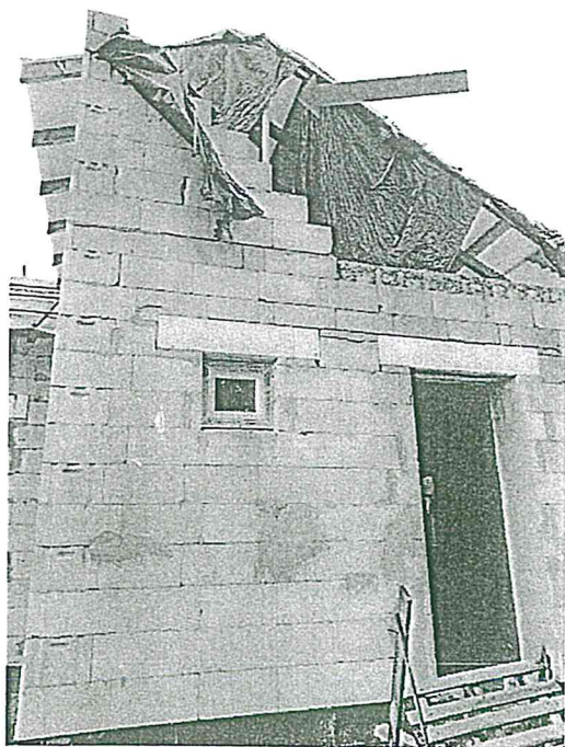
14. fénykép: Az időjárás elleni védelem nem megfelelő
