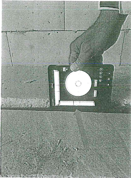
26. fénykép: A vezeték vízszintes, nem szabályos!
