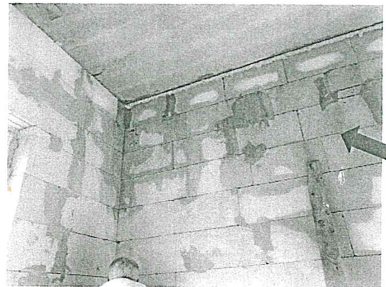
29. fénykép: A belső falazat is leázott
