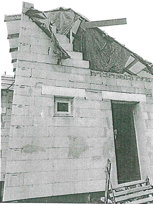
14. fénykép: Az időjárás elleni védelem nem megfelelő
