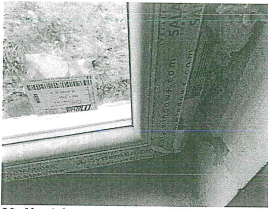
22. fénykép: Beépített műanyag nyílászáró
