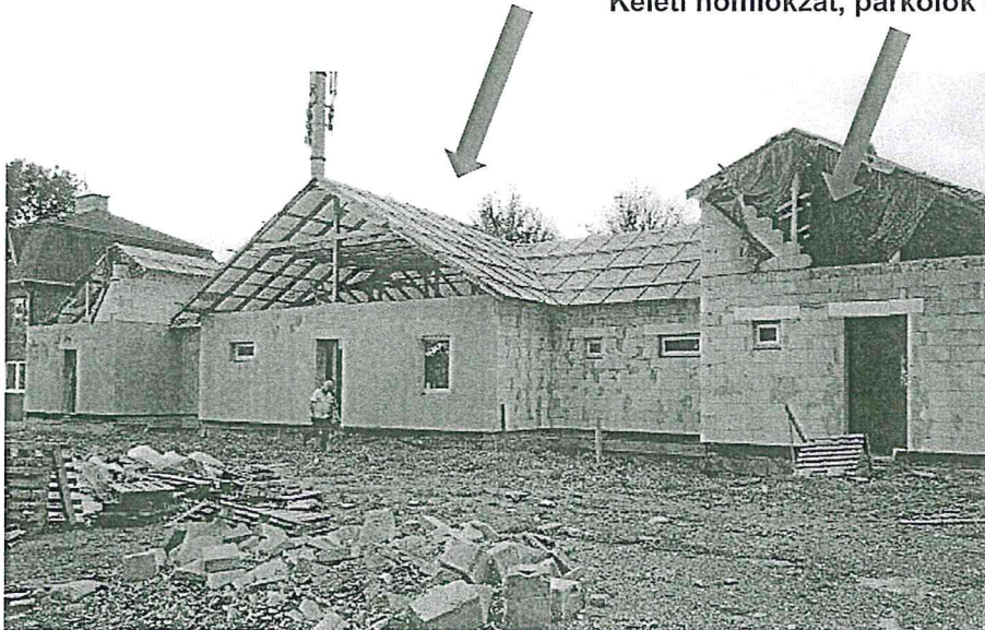
9. fénykép: Keleti homlokzat, időjárás elleni védelem hiánya
