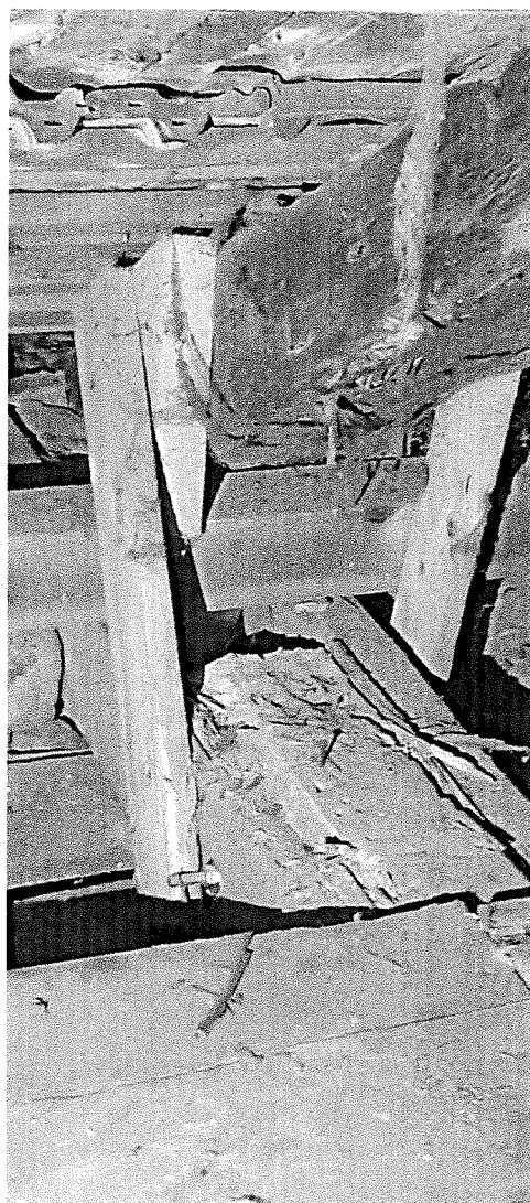
5. kép I. tetőszakaszon javított csomópont
